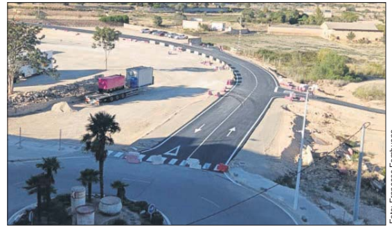
Estat de les obres del nou accés a la ronda de Mura.
